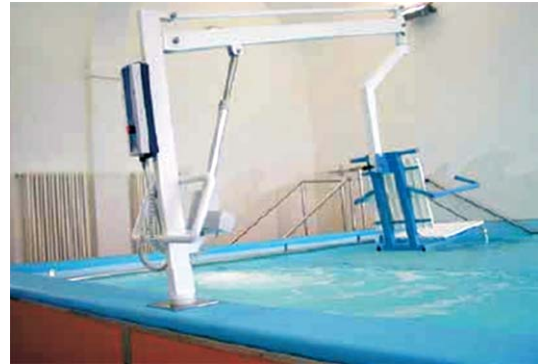
Figura 8.2. Detalle donde se observa el muro y la grúa de acceso de los pacientes a la piscina. En su extremo se encuentra una silla especial que tiene sistemas de fijación.
